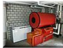
EM 011 Trocknungsraum EG Heizung
